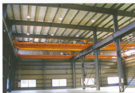
天井走行クレーン (1.0t ~ 20.0t 程度)
